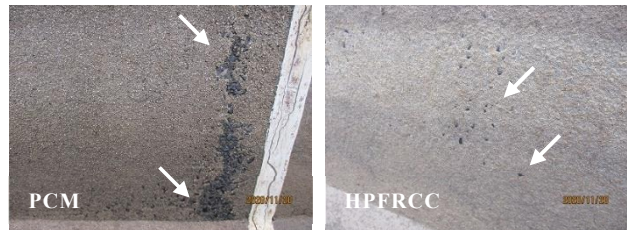
Fig. 1 コンクリートの骨材の露出に至った無機系被覆材の摩耗
